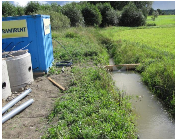
Figur 12: Anläggningen i Väringe utanför Nyköping.
